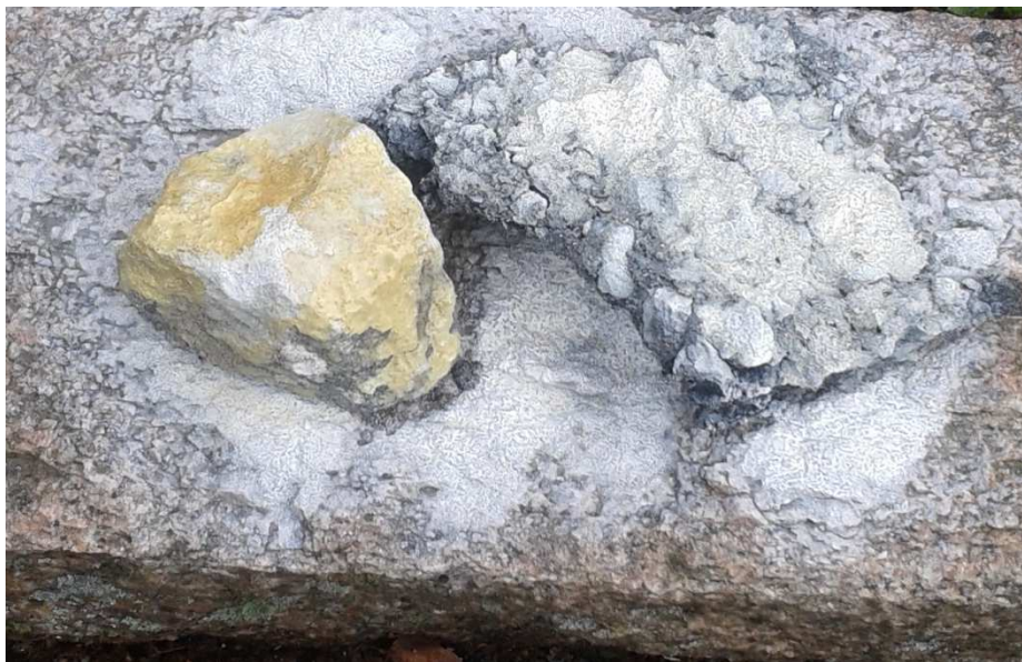
Figur 5 Fältkontroll av asfalt och bärlager i 16ÅF04. Ytbeläggning på sten från bärlager indikerar starkast på tjärasfalt. Lukt av tjärasfalt var tydlig i provtagningspunkten.
